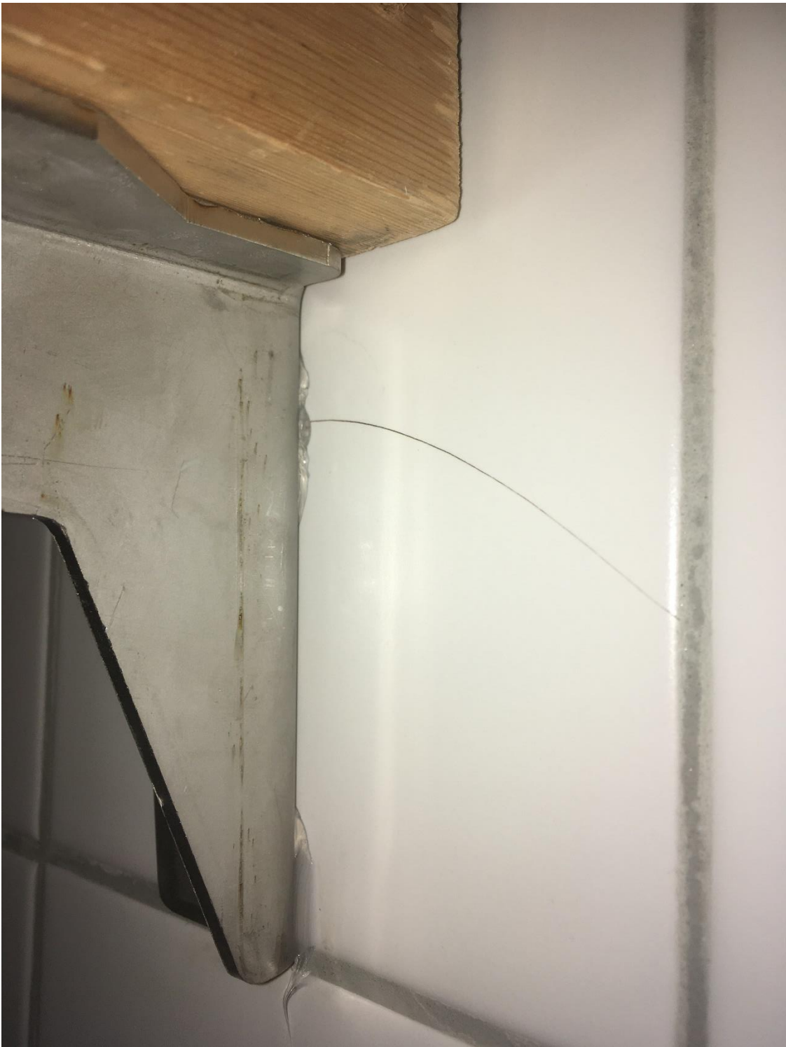
9. Pågående provning. Belastning med statisk last. Sprickbildning i kakelplatta.
